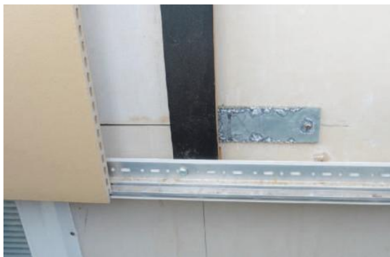
Рисунок 2. Коррозия металлических поверхностей, соприкасающихся с МЛ.
