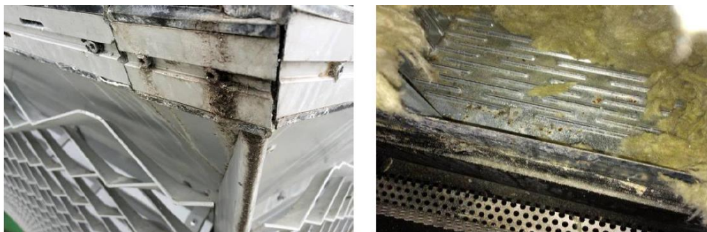
Рисунок 4. Коррозия конструкции «Dokk1». Фото: Технологический Институт.
